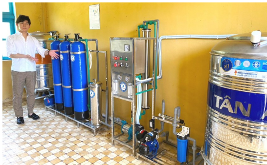
アレック小学校、飲料水浄化システム
